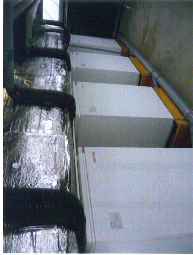
Piskbalkongen med fyra värmepumpar Stiebel Eltron WPL23 och frånluftskanalen.
